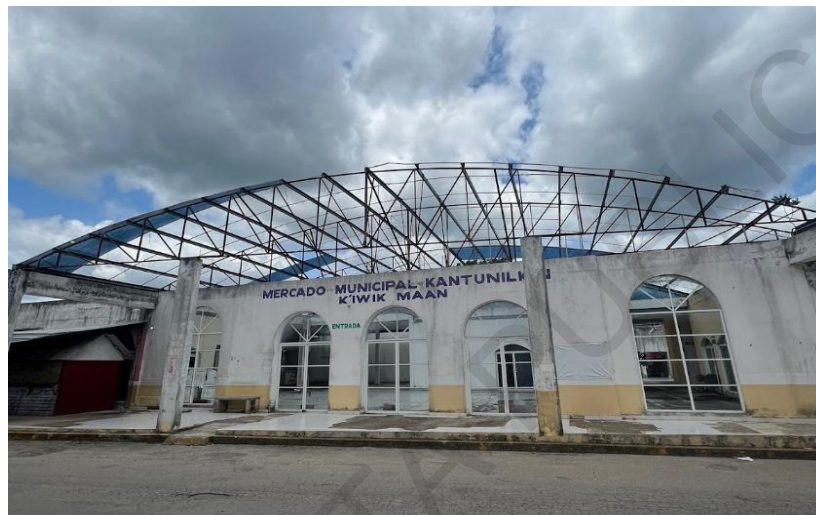
Fotografía 31. Mercado Municipal de Kantunilkín abandonado. Fuente: Fotografía a partir de exploración de campo.
